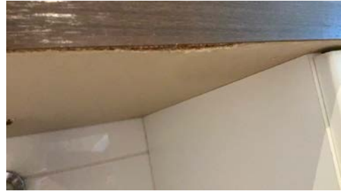
Svelling under benkeplate.
