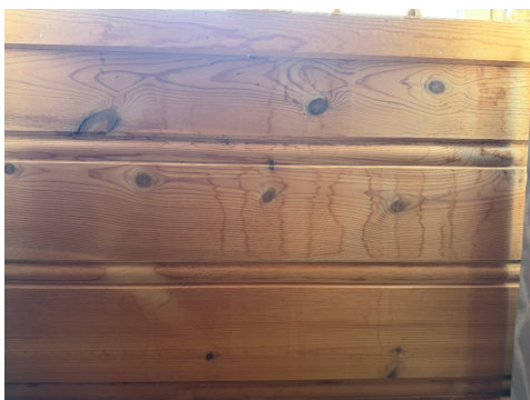
Fuktskjolder under vindu i kjellerstue.
