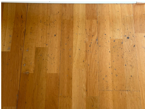
Slitasje/striper i parkettgulv på kjøkken.
