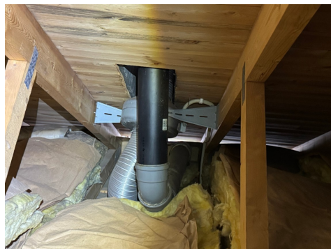
Manglende isolasjon bak rørgjennomføring.
