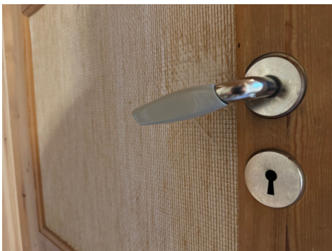
Slitasje på innerdør i u-etg.
