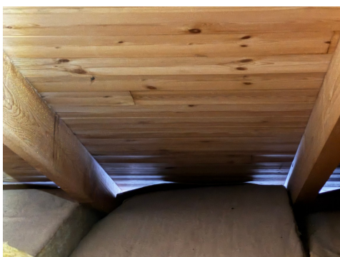
Liten luftespalte mellom isolasjon - sutak.
