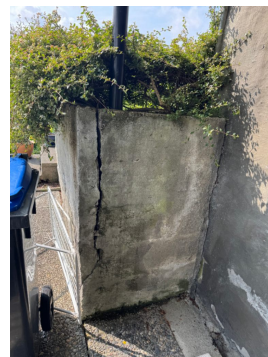
Malingsflass på grunnmur og sprekk i hagemur.
