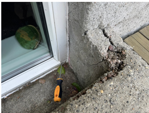
Råte i utvendig vinduskarm.
