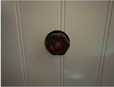
Stoppekran på vaskerom.
