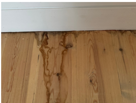
Fuktmerker på soverom i u-etg. Fukt ble registrert på soverommet på befaringdagen.
