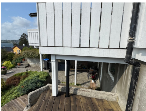
Manglende rekkverk v/ nivåforskjell.
