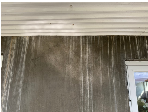
Rennemerker langs grunnmur under altan.
