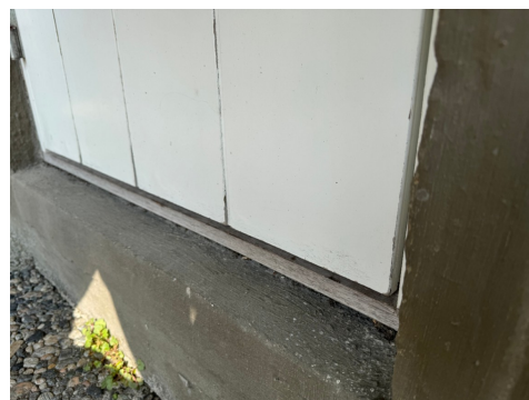
Svelling i nedre del av ytterdør i bod med utvendig adkomst.
