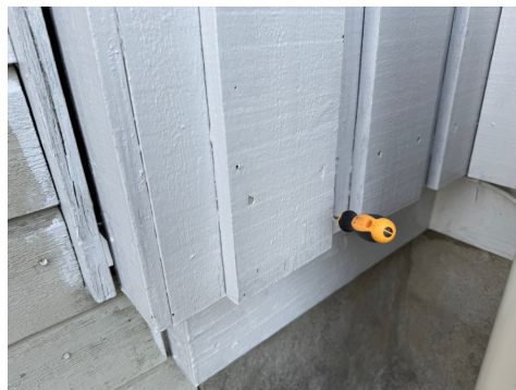
Råte i nedre del av kledningsbord.
