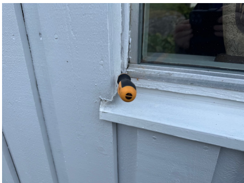
Råte i utvendig vinduskarm.
