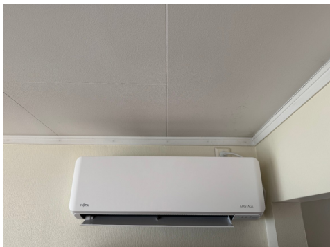
Varmepumpe med uttak i stue.
