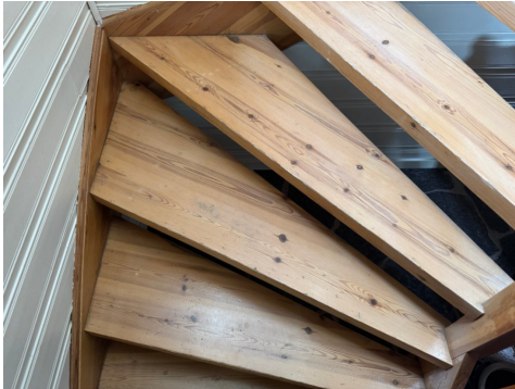
Slitasje/bruksmerker i trappetrinn.
