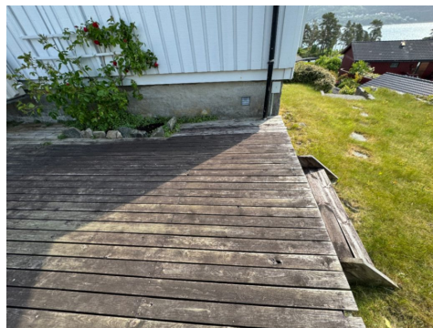
Slitasje og skjevheter i terrasseplating.
