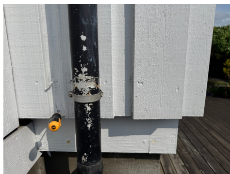
Råte i nedre del av kledningsbord.
