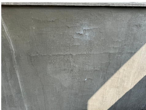
Riss i grunnmur.
