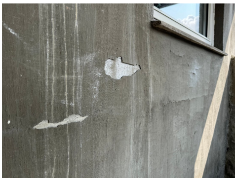
Malingsflass på grunnmur.
