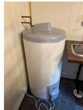
Varmtvannstank på vaskerom.
