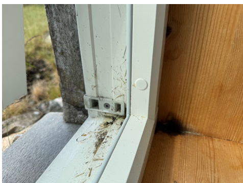
Fukttinntrenging v/ vindu i kjellerstue.
