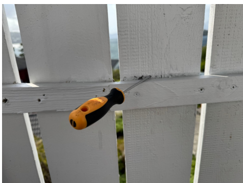
Råte i rekkverksbord.
