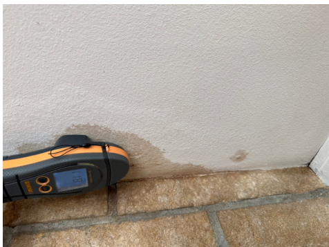
Fuktmerker v/ pipe i stue etter tidligere lekkasje. Ingen forhøyede fuktverdier ble registrert på befaringdagen.
