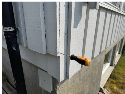
Råte i nedre del av kledningsbord.
