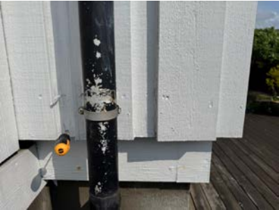
Råte i nedre del av kledningsbord.
