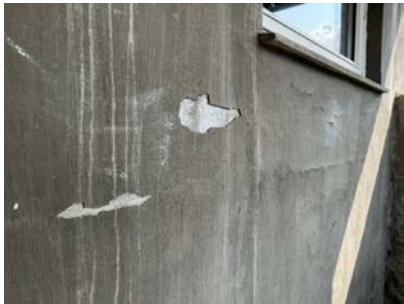
Malingsflass på grunnmur.
