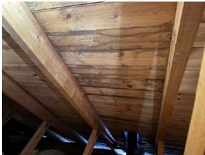
Misfarging/soppdannelse i sutak. Det kan skyldes kondens pga. utettheter i dampsperre/plast.
