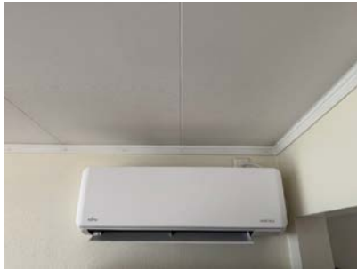
Varmepumpe med uttak i stue.
