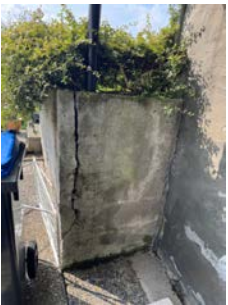
Malingsflass på grunnmur og sprekke i hagemur.
