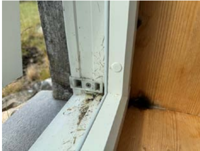
Fuktnntrenging v/ vindu i kjellerstue.
