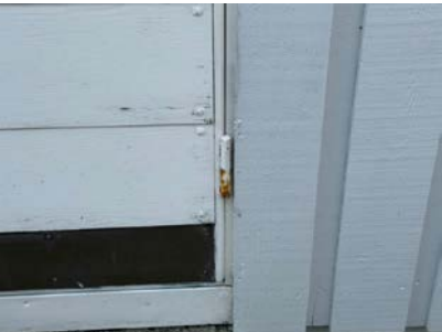
Rust på utvendig hengsel på ytterdør i hoved-etg.
