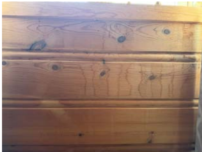
Fuktskjolder under vindu i kjellerstue.
