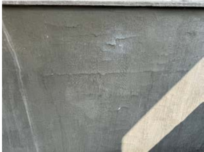
Riss i grunnmur.
