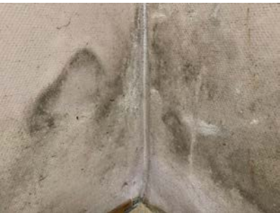
Dreneringen er utilstrekkelig og har idag begrenset effekt.
