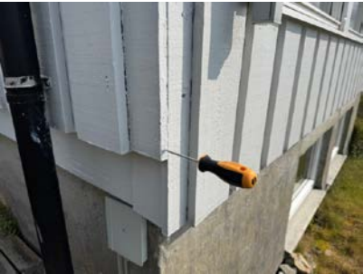
Råte i nedre del av kledningsbord.
