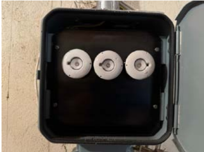
Inntaksikringer i bod.
