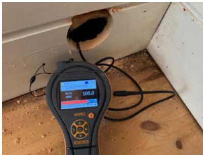
Måling av trefukt/vektprosent.
