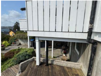
Manglende rekkverk v/ nivåforskjell.
