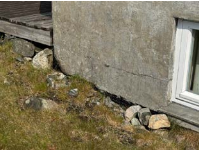
Synlig knotteplast inntil grunnmuren.
