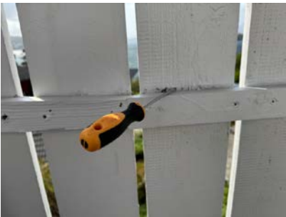
Råte i rekkverksbord.
