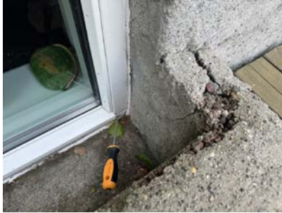
Råte i utvendig vinduskarm.
