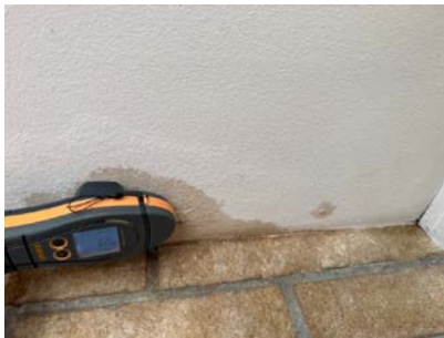
Fuktmerker v/ pipe i stue etter tidligere lekkasje. Ingen forhøyede fuktverdier ble registrert på befaringsdagen.
