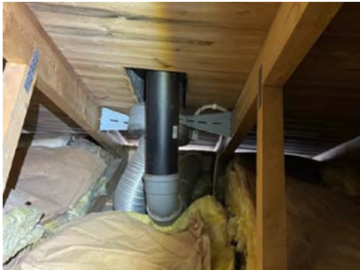
Manglende isolasjon bak rørgjennomføring.
