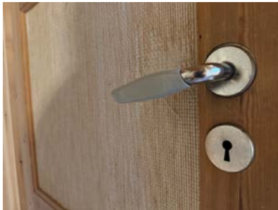
Slitasje på innerdør i u-etg.
