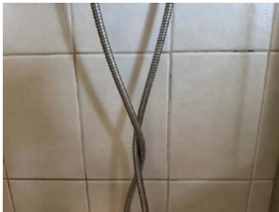
Slitasje/riss i flisefuger i dusjsone.
