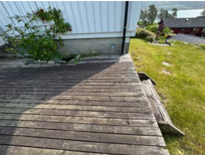
Slitasje og skjevheter i terrasseplating.
