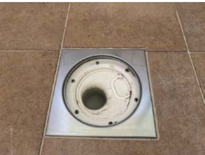
Plastsluk i dusjsone.
