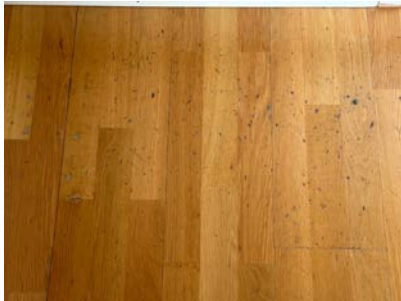
Slitasje/striper i parkettgulv på kjøkken.
