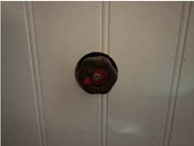
Stoppekran på vaskerom.
