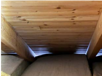
Liten luftespalte mellom isolasjon - sutak.
