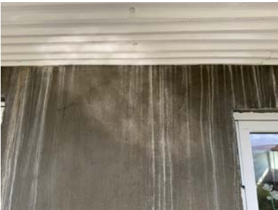
Rennemerker langs grunnmur under altan.
