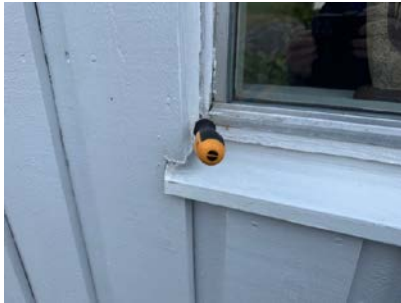
Råte i utvendig vinduskarm.
