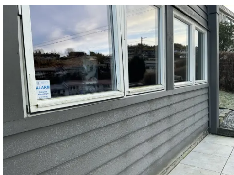
Mangler vannbord under vinduer i u.etg (TG 2)
