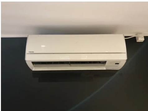
Varmepumpe i u.etg
