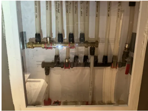
Fordelerskap på vaskerom.
