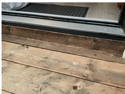
Mangler beslag under terrassedør fra kjøkken (TG 2)
