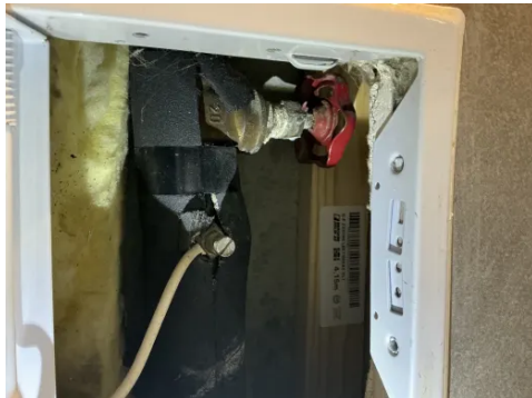
Stoppekran plassert på bad (inspeksjonsluke ved toalett)
