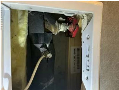
Stoppekran plassert på bad (inspeksjonsluke ved toalett)
