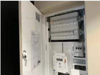
Sikringsskap i gang u.etg
