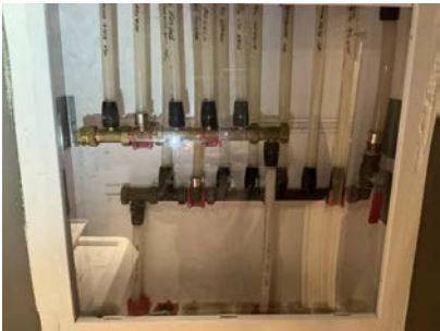
Fordelerskap på vaskerom.
