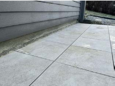
Vertikalriss i grunnmur.
