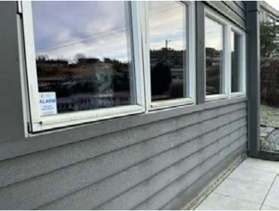
Mangler vannbord under vinduer i u.etg (TG 2)
