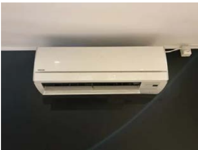
Varmepumpe i u.etg
