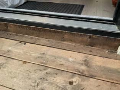
Mangler beslag under terrassedør fra kjøkken (TG 2)
