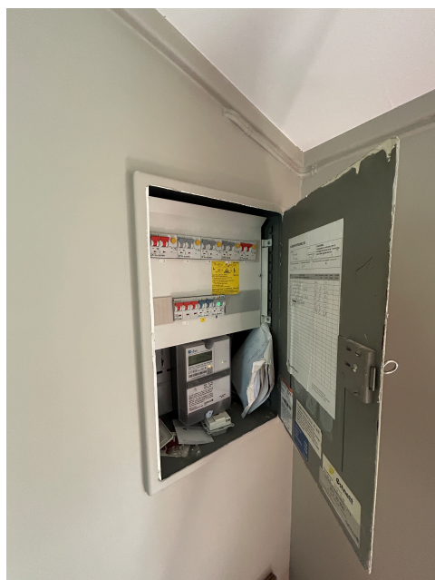
Sikringsskap plassert i gang.
