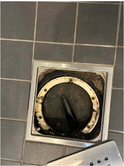
Sluk på bad i 1.etasje
