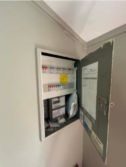
Sikringsskap plassert i gang.
