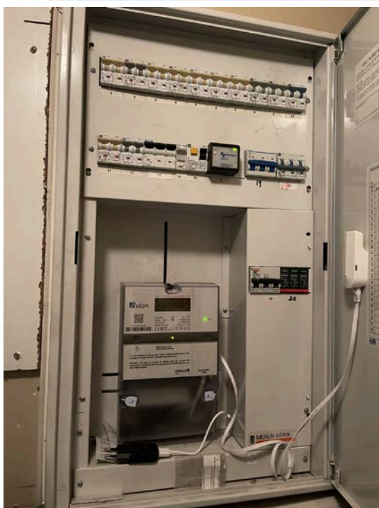
Sikringsskap med automatsikringer.
