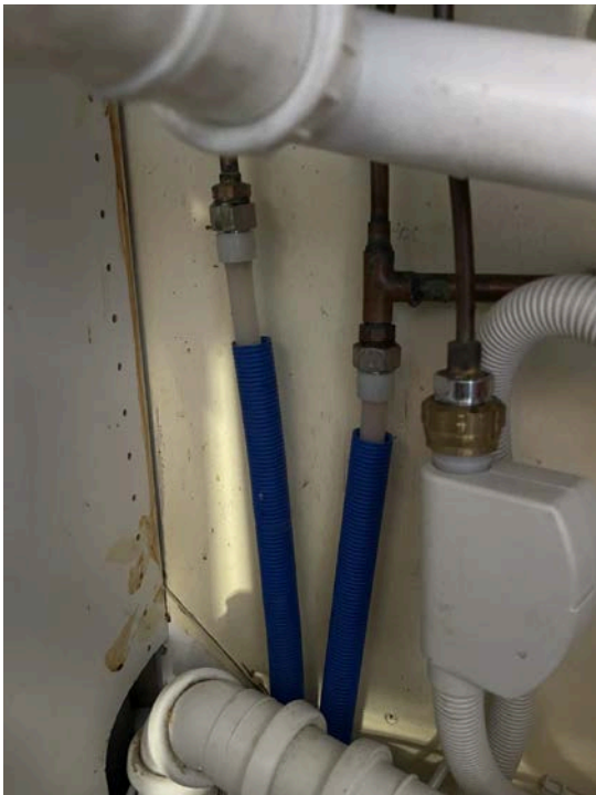
Mangler tettering mellom pex-rør og varerør.
