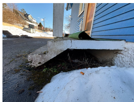
Gjennomgående sprekk i trapp.
