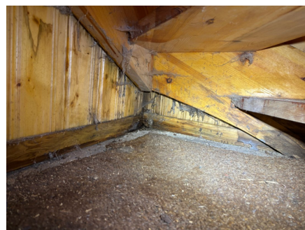
Råte i trekonstruksjon under trapp.
