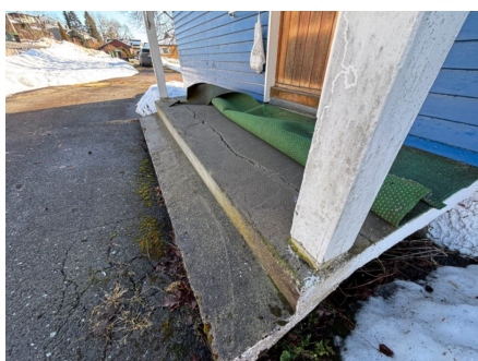
Langsgående sprekk i trapp.
