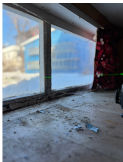
Avflassing og begynnende råte i vindu
