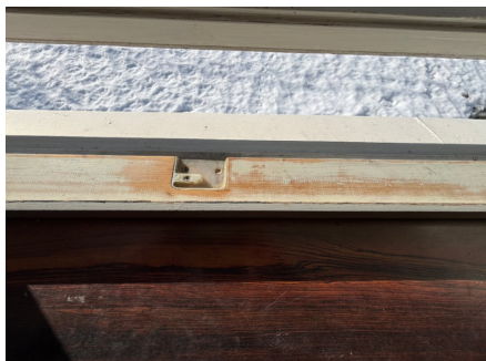
Vindu har ikke pakning og tar i karm.
