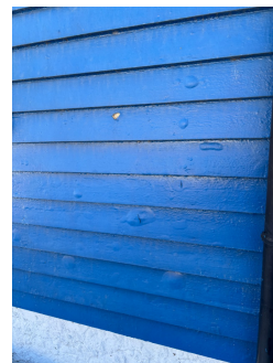
Bobler og avflassing av overflatebehandling.
