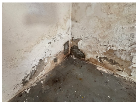
Avleiring av salt/kalkutslag observeres stedvis på grunnmur.
