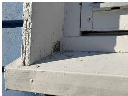
Begynnende råte i bunn av omramming.
