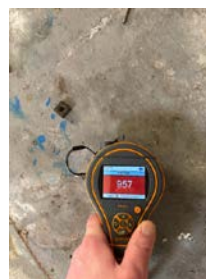
Det er ved overflatesøk påvist indikasjoner på fuktgjennomtrenging i kjellergulv.
