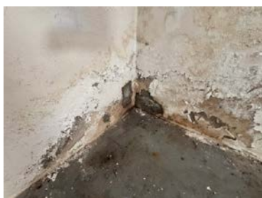
Avleiring av salt/kalkutslag observeres stedvis på grunnmur.
