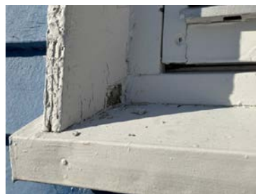
Begynnende råte i bunn av omramming.
