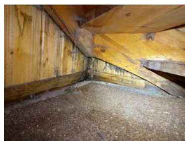
Råte i trekonstruksjon under trapp.
