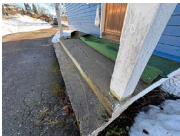
Langsgående sprekk i trapp.
