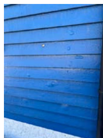
Bobler og avflassing av overflatebehandling.
