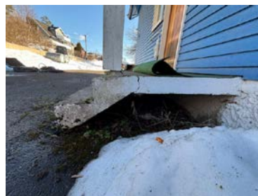
Gjennomgående sprekk i trapp.
