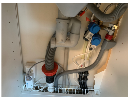
Rørøpplaget i kjøkken
