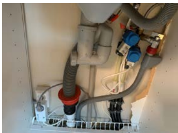
Røropplegget i kjøkken
