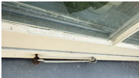
Eksempelbilde av oppsprukket kittfals.
