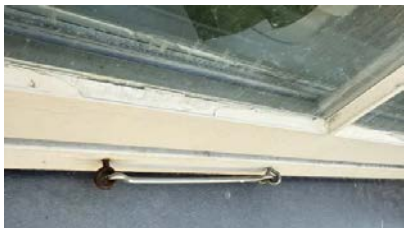
Eksempelbilde av oppsprukket kittfals.
