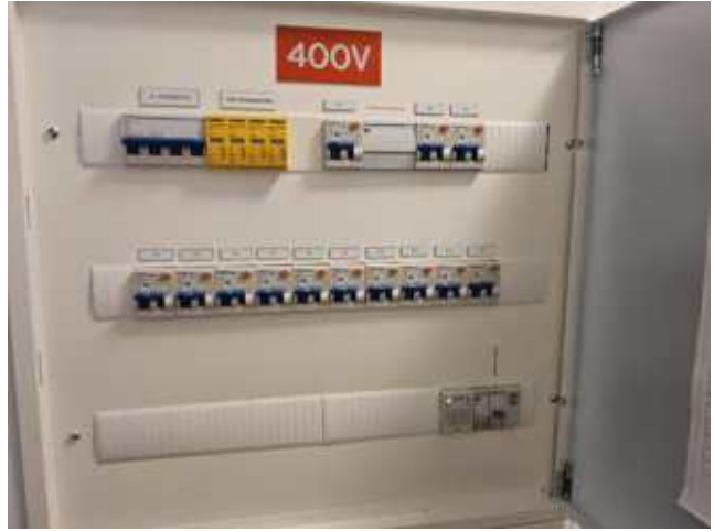
Elektrisk anlegg - [Sikringskap.]
