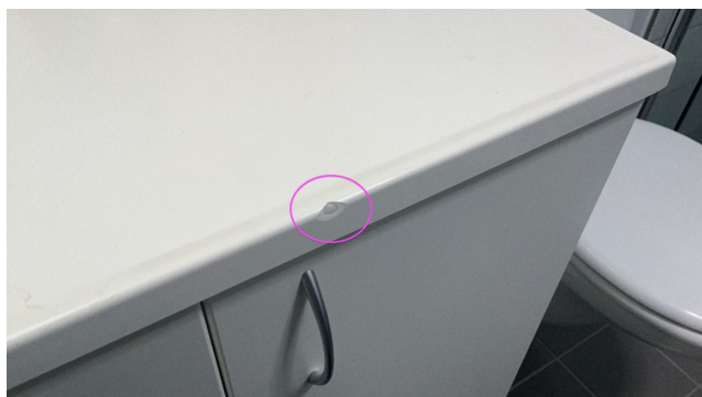
Skade på servant.
