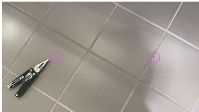
Skall har gått av to gulvfliser.
