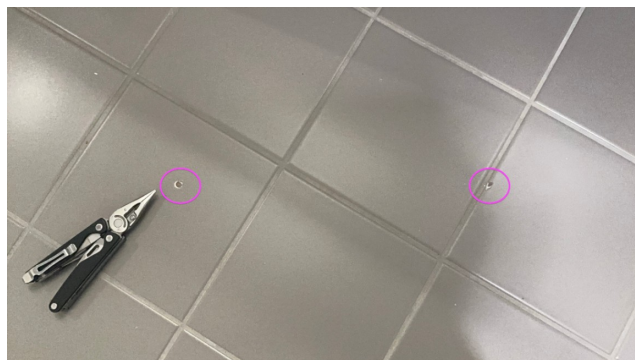
Skall har gått av to gulvfliser.
