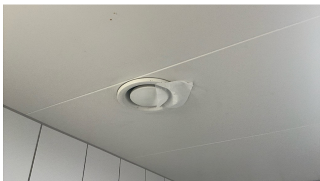
Test av avtrekk. Papiret henger.
