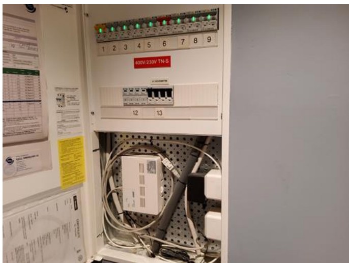
Elektrisk anlegg - [Sikringsskap ]
