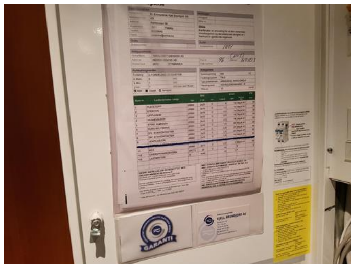
Elektrisk anlegg - [Kursoversikt ]
