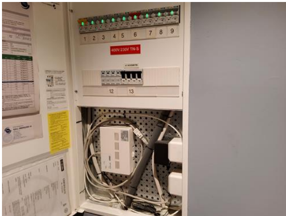
Elektrisk anlegg - [Sikringskap ]
