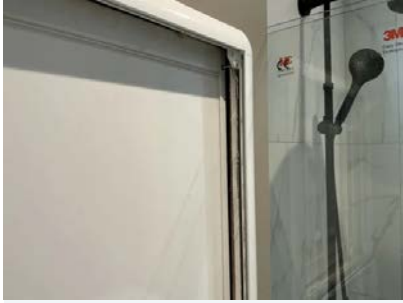
Mangler fuksikring ifm vannskap.
