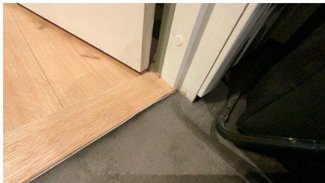
Synlige avvik rundt dørterskler.
