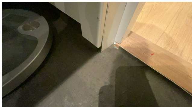
Synlige avvik rundt dørterskler.
