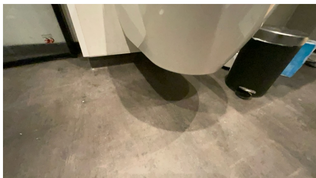
Lekkasjespalte på innebygget sistene bør opparbeides.
