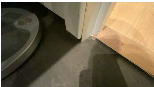
Synlige avvik rundt dørterskler.
