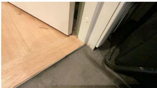
Synlige avvik rundt dørterskler.
