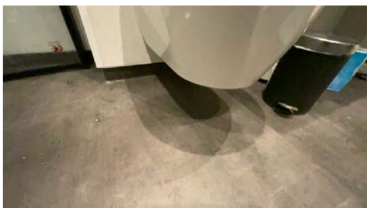
Lekkasjespalte på innebygget sistene bør opparbeides.
