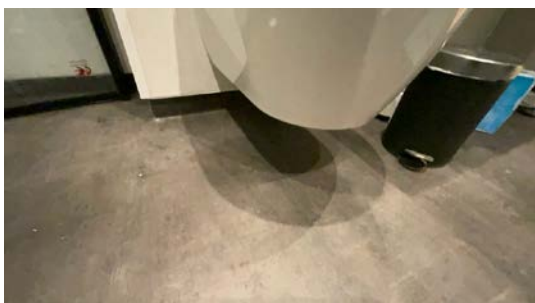
Lekkasjespalte på innebygget sistene bør opparbeides.
