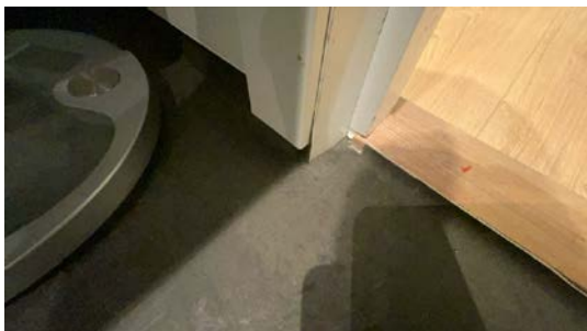
Synlige avvik rundt dørterskler.
