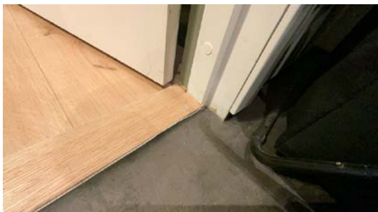
Synlige avvik rundt dørterskler.
