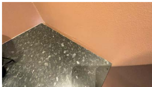
Benkeplate er ikke helt ut til vegg.
