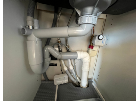
Røropplegg i kjøkkenbenk med Waterguard
