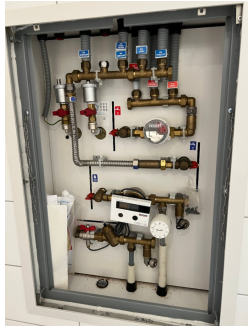
Samleskap med rørkurser og stoppekraner
