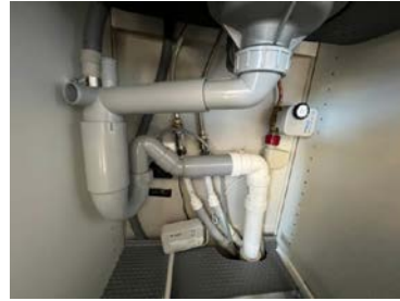
Rørøpplagg i kjøkkenbenk med Waterguard
