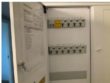
Sikringskap med kursoversikt.
