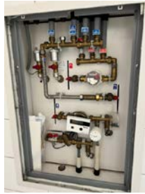
Samleskap med rørkurser og stoppekraner
