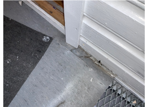
Gulvbelegg i fellesområdet utenfor leilighetene i andre etasje; sprukket opp.
