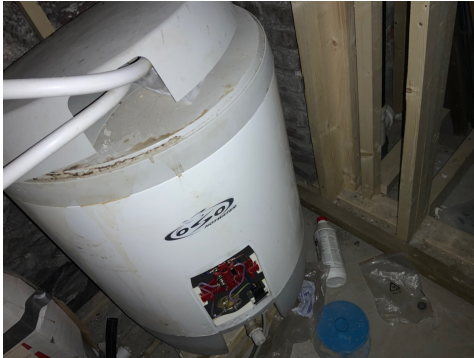
Leilighet H0202; varmtvannsbereder montert i 1 etg./ fellesområder. Plasseringen er midlertidig.
