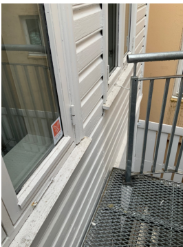
Åpning mellom vegg og trapperepos mer enn 10 cm.
