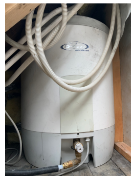
Leilighet H0201; varmtvannstank på loftet.
