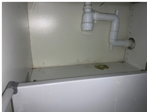
Rør under kjøkkenvask.
