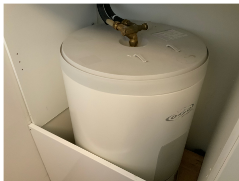
Leilighet H0101; varmtvannstank montert på soverom.
