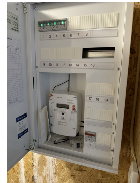
Sikringsskap for fellesområder, montert i fellesområde, 1 etg.
