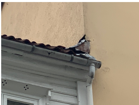
Beslag mot nabo bør kontrolleres for tetthet (bildet er tatt i front av bolig). Det vil være naturlig å sjekke/montere nye beslagsløsninger ved ny tekking.
