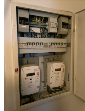
Leilighetene H0101 og H0201 deler sikringsskap i fellesgang/ hovedinngang.
