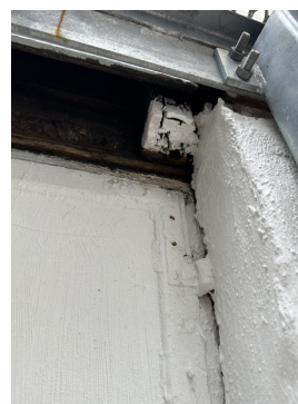
Bildet viser råteskade i nedre del av tømmerkonstruksjon (bildet er tatt over gammelt vindu i bakgården). Tømmerkonstruksjonen er nesten 200 år.
