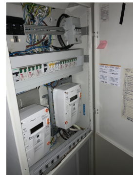
Leilighetene H0202 og H0301 deler sikringsskap, montert i H0202 (i gangen)
