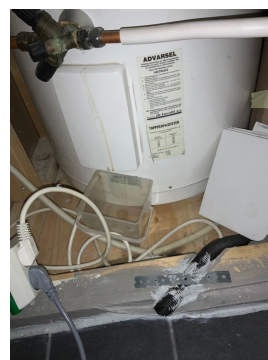
Leilighet 0301; varmtvannstank montert i hukk ved bad.
