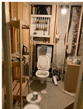
Montert toalett som er i drift (sluk ved toalett)
