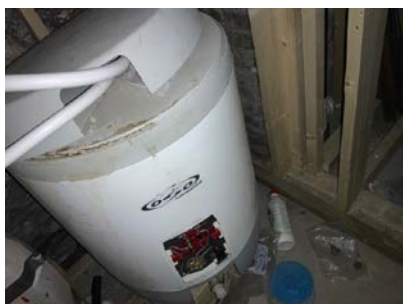
Leilighet H0202; varmtvannsbereider montert i 1 etg./ fellesområder. Plasseringen er midlertidig.
