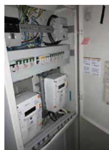
Leilighetene H0202 og H0301 deler sikringsskap, montert i H0202 (i gangen)
