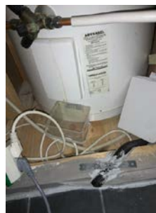
Leilighet 0301; varmtvannstank montert i hukk ved bad.
