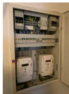
Leilighetene H0101 og H0201 deler sikringsskap i fellesgang/ hovedinngang.
