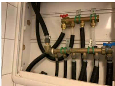
Rørskap/ fordelerskap, rør-i-rør (leilighet H0101).
