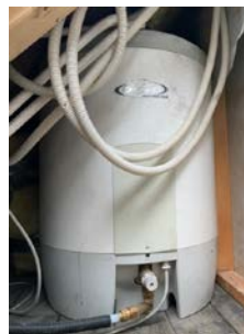
Leilighet H0201; varmtvannstank på loftet.
