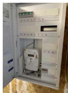
Sikringsskap for fellesområder, montert i fellesområde, 1 etg.
