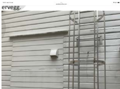
Avtrekk fra kjøkken i yttervegg
