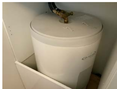
Leilighet H0101; varmtvannstank montert på soverom.
