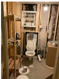
Montert toalett som er i drift (sluk ved toalett)
