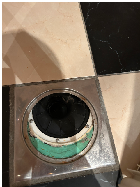
Sluk på bad i kj.etasje
