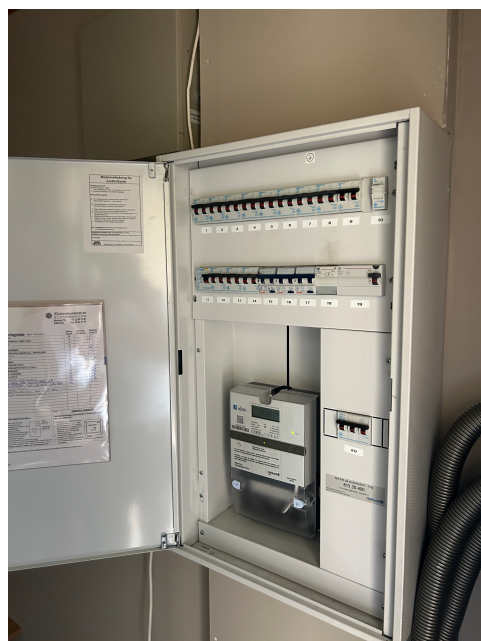
Sikringsskap plassert i gang.
