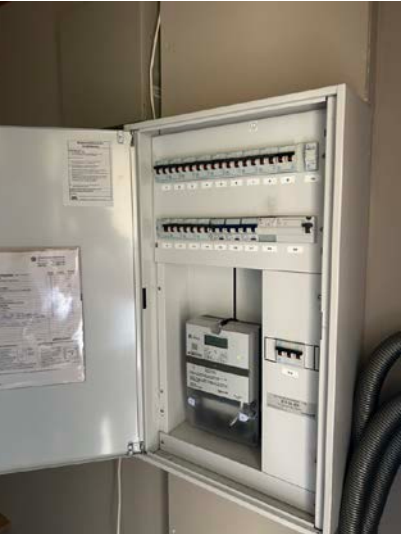
Sikringsskap plassert i gang.
