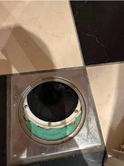
Sluk på bad i kj.etasje
