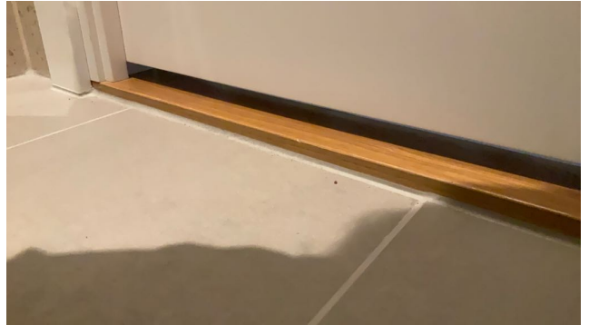
Overstrømming under døren.
