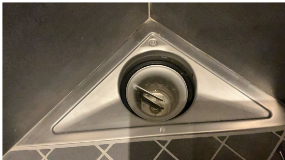
Sluk i dusjsone.
