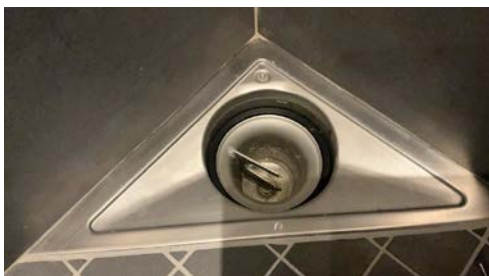
Sluk i dusjsone.
