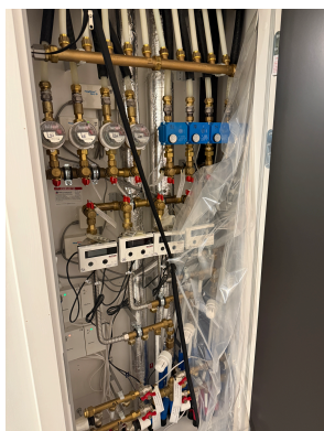
Skap i fellesgang med stoppekran
