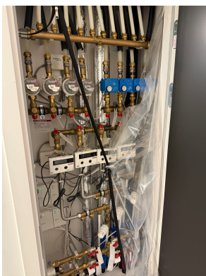
Skap i fellesgang med stoppekran
