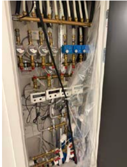
Skap i fellesgang med stoppekran
