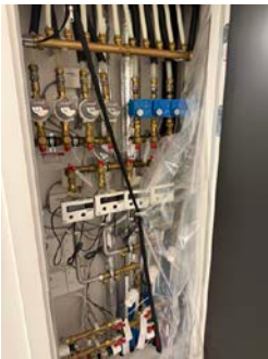
Skap i fellesgang med stoppekran
