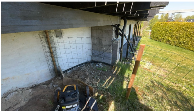
Synlige avvik på endevegg mot nabo.
