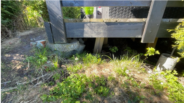
Synlige avvik på fundamenter.
