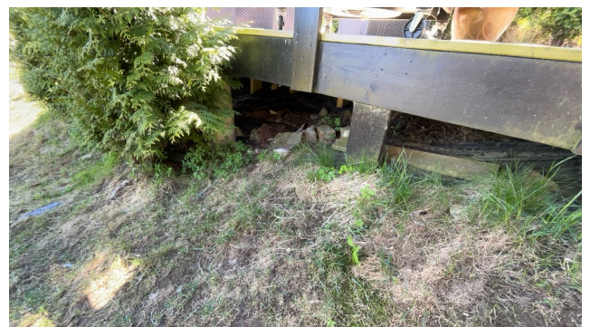
Synlige avvik på fundamenter.
