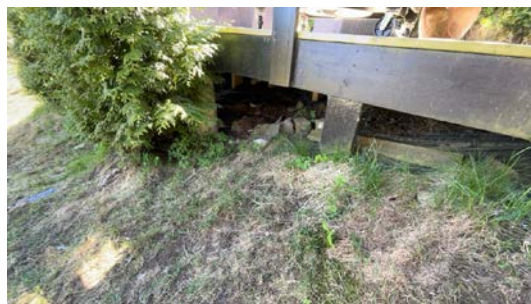
Synlige avvik på fundamenter.
