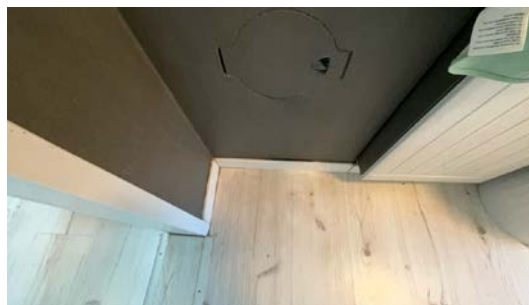
Ildplate på gulv bør opparbeides.
