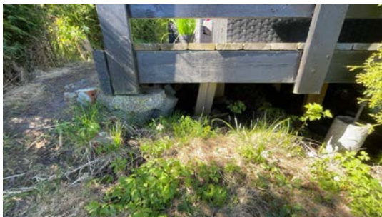
Synlige avvik på fundamenter.
