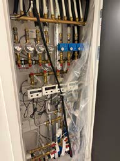
Skap i fellesgang med stoppekran
