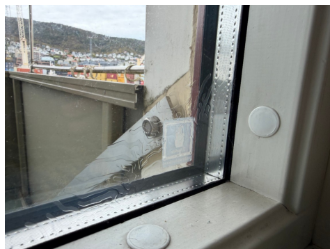
Folie på innside av flere isolerglass har krympet. Synlige ujevnheter i folie ble observert flere steder.
