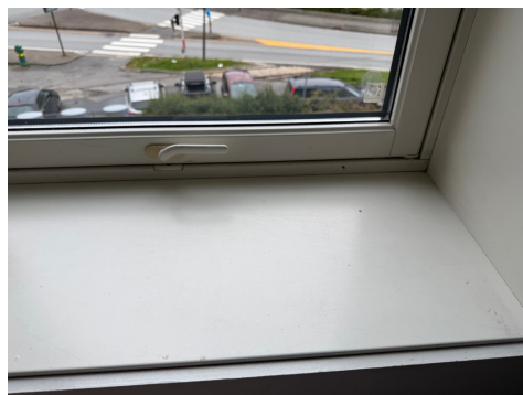
Slitasje/striper i vindustilsetning.
