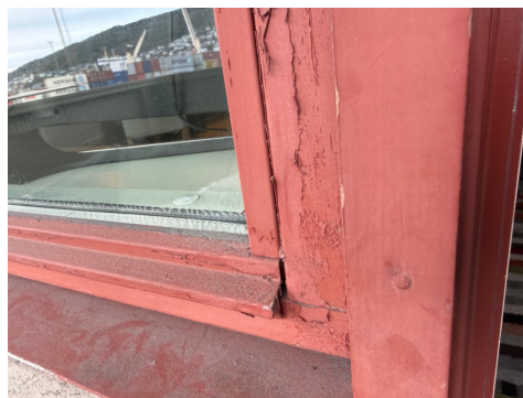
Malingslitt på utvendig karm på stuevindu.
