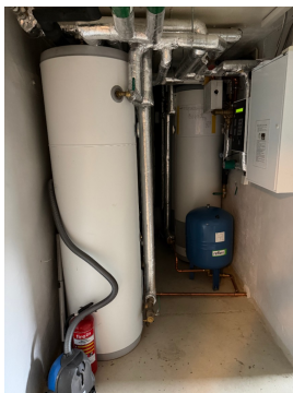
Felles varmtvannstanker i u-etg.
