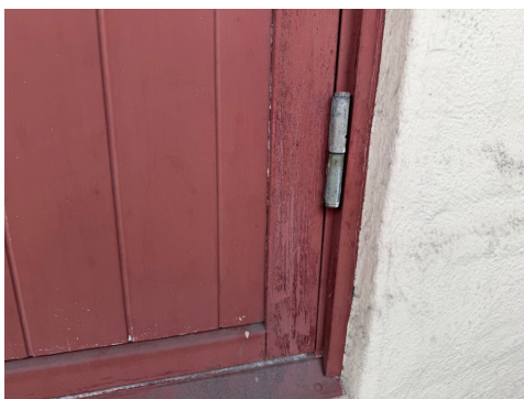
Malingslitt altandør. Altandør bør vedlikeholdes/males.
