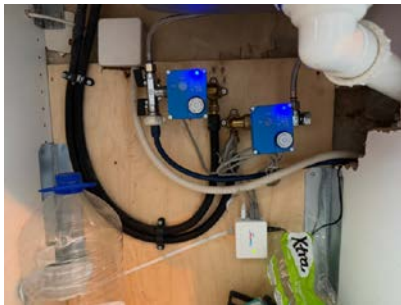
Røropplegg og aquastop under vask.
