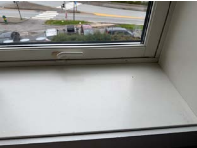
Slitasje/striper i vindustilsetning.
