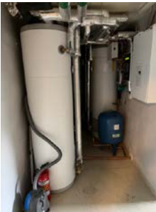
Felles varmtvannstanker i u-etg.
