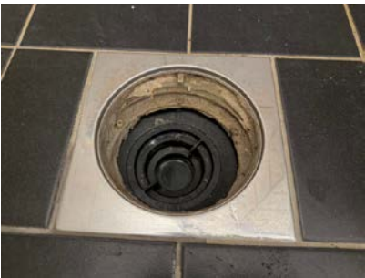
Plastsluk i dusjsone.
