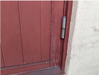
Malingslitt altandør. Altandør bør vedlikeholdes/males.
