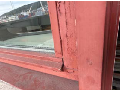
Malingslitt på utvendig karm på stuevindu.
