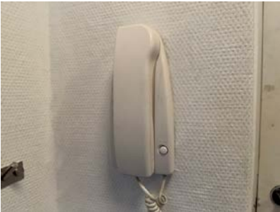
Dørtelefon i entre/gang.
