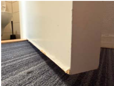
Fuktutsvelling/slitasje i nedre del av badedør.
