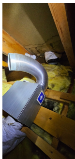
Ventilasjonsanlegg med utkast på loftet.
