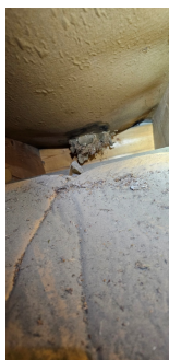
Hull i undertaket hvor det har kommet inn diverse blader og liknende.
