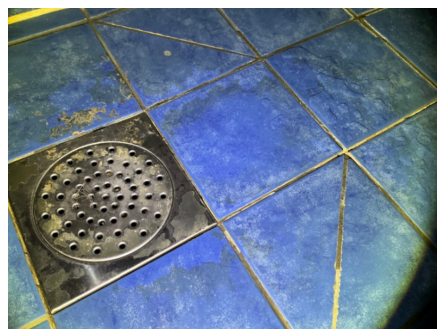
Store avskallinger i fuger.
