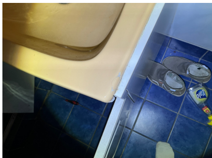
Sprekk i servanten.
