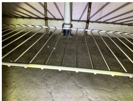
Ikke tilstrekkelig tetting rundt rør.
