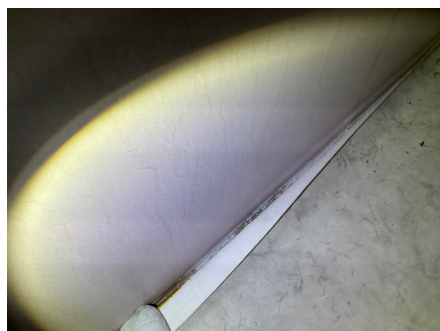
Avvik i overgang gulv og vegg.
