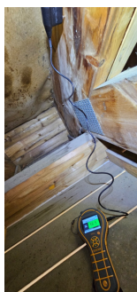
Fuktmåling på takspærre med fukt merker.
