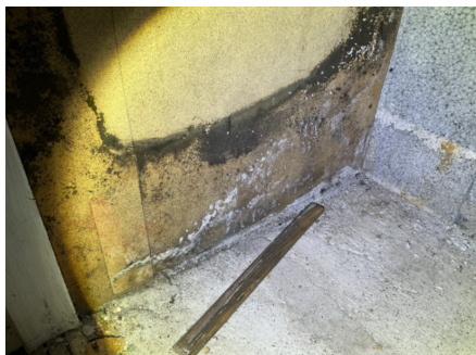
Svertesopp og annet på vegg i kjeller.
