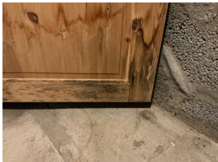
Fuktmerker på dør i kjeller.
