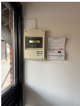
Felles brannvarslingsanlegg i bygget
