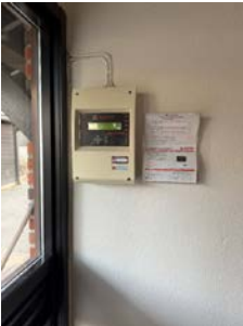
Felles brannvarslingsanlegg i bygget
