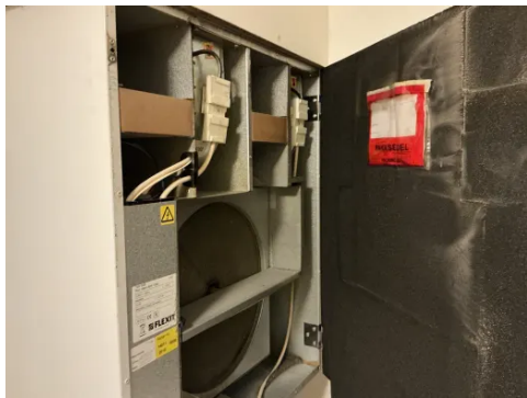
Ventilasjonssentral for balansert ventilasjon.
