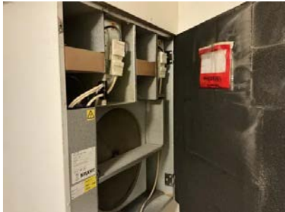
Ventilasjonssentral for balansert ventilasjon.
