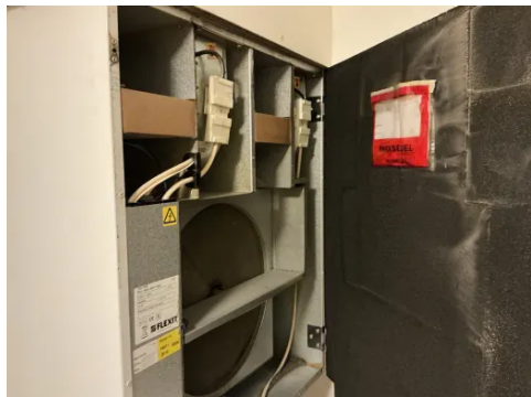
Ventilasjonssentral for balansert ventilasjon.
