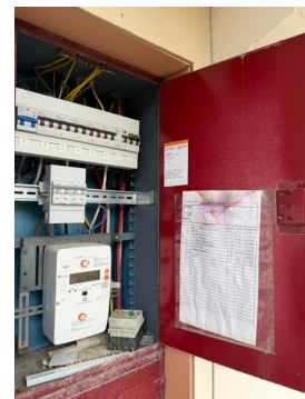
Sikringskap i yttervegg. Utvendig adkomst.
