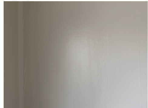
Ujevne overflater på soverom.
