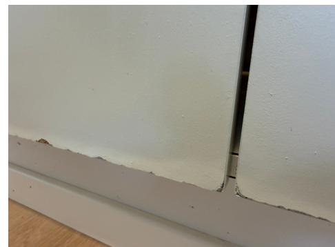
Fuktutsvelling i nedre del av skapfront.
