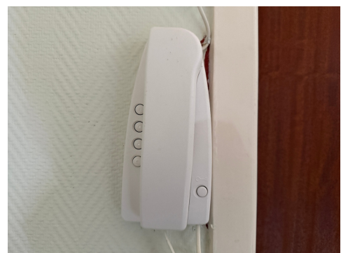
Dørtelefon i entre/gang.
