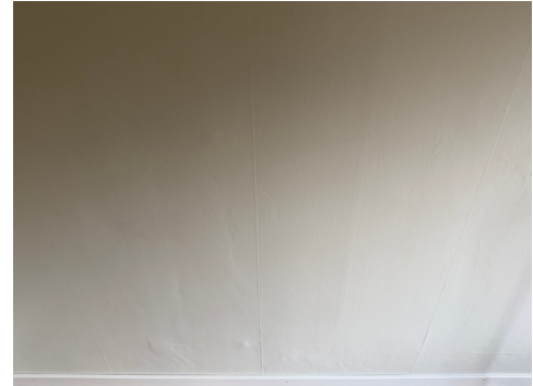
Ujevne overflater på soverom.
