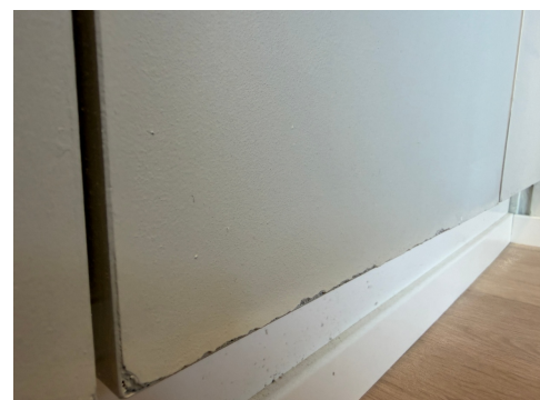
Fuktutsvelling i nedre del av skapfront.
