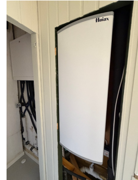
Varmtvannstank i nisje/skap på kjøkken.
