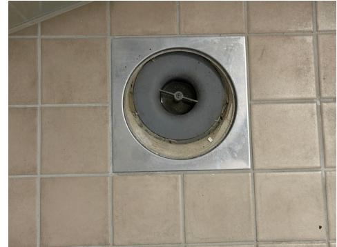
Plastsluk i dusjsone.
