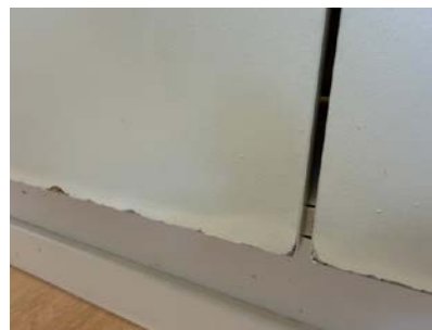
Fuktutsvelling i nedre del av skapfront.
