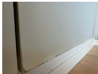
Fuktutsvelling i nedre del av skapfront.
