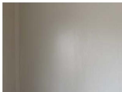
Ujevne overflater på soverom.
