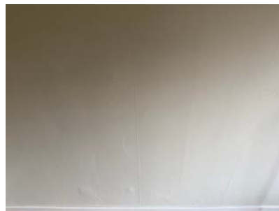
Ujevne overflater på soverom.
