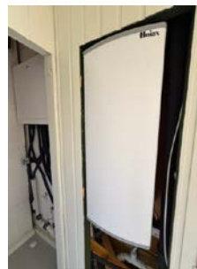
Varmtvannstank i nisje/skap på kjøkken.
