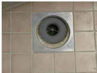
Plastsluk i dusjsone.
