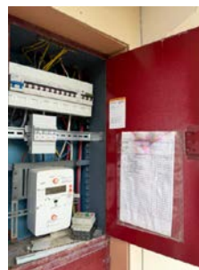
Sikringsskap i yttervegg. Utvendig adkomst.
