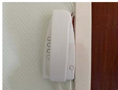
Dørtelefon i entre/gang.
